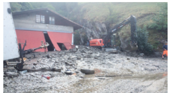
Umgebung bei der Postautogarage im Chi anlässlich des Hochwasserereignisses 2015.
